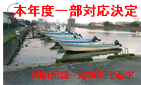
老朽化した防潮堤(津市の旧津港)
