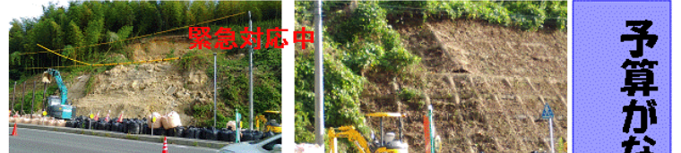
緊急対応中 桑名インターと交差する県道の地すべり。隣接してふくらみ亀裂が入った法面
